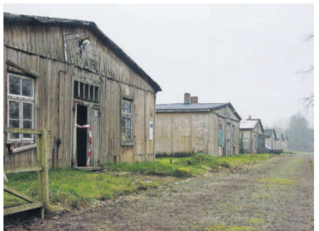
Die Bausubstanz der noch existenten Lagerbaracken hat erheblich gelitten. Erste Sicherungsmaßnahmen sichern den Bestand der unter Denkmalschutz stehenden Bauten. LAF-FOTO: LARS FISCHER
